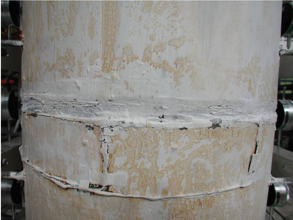
照片 3.85 試體 3 第一、二節塊間混凝土裂縫長度( \theta = +0.04 弧度)
