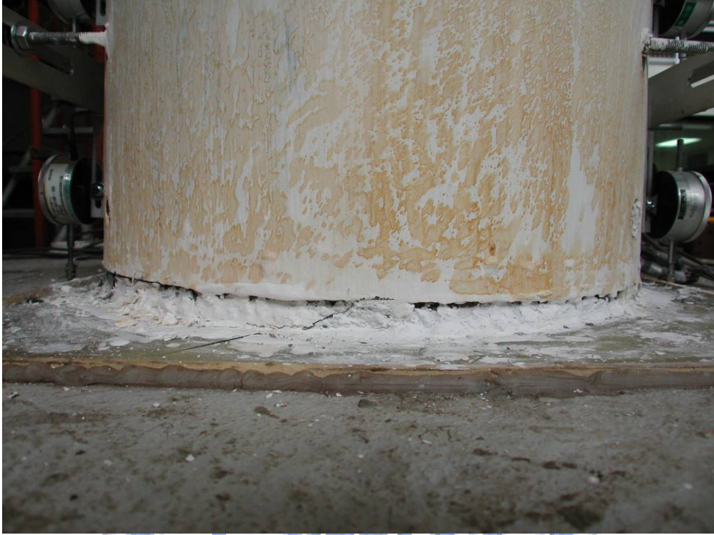
照片 3.77 試體 3 第一節塊柱底混凝土裂縫長度( \theta = +0.03 弧度)
