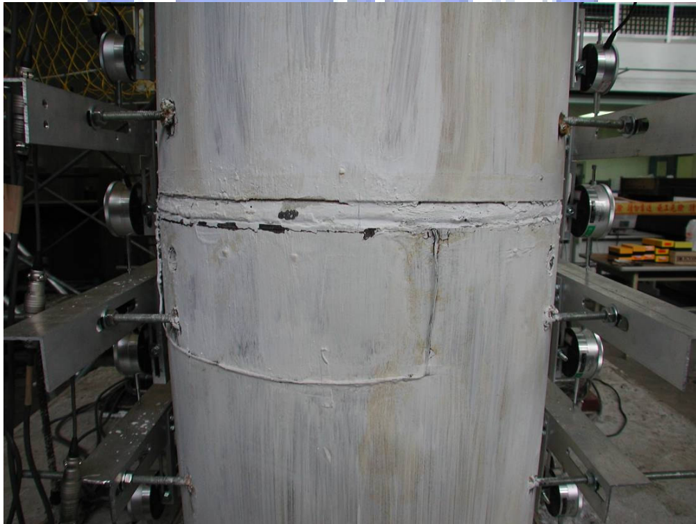
照片 3.36 試體 2 第一、二節塊間混凝土裂縫長度( \theta = +0.02 弧度)
