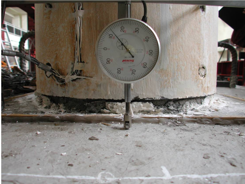
照片 3.71 試體 3 第一節塊柱底撓曲裂縫( \theta = +0.02 弧度)
