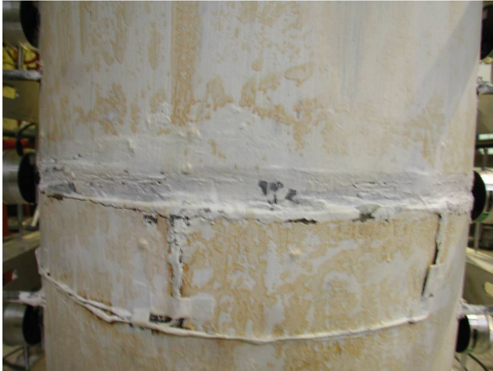
照片 3.97 試體 3 第一、二節塊間混凝土裂縫長度( \theta = +0.06 弧度)
