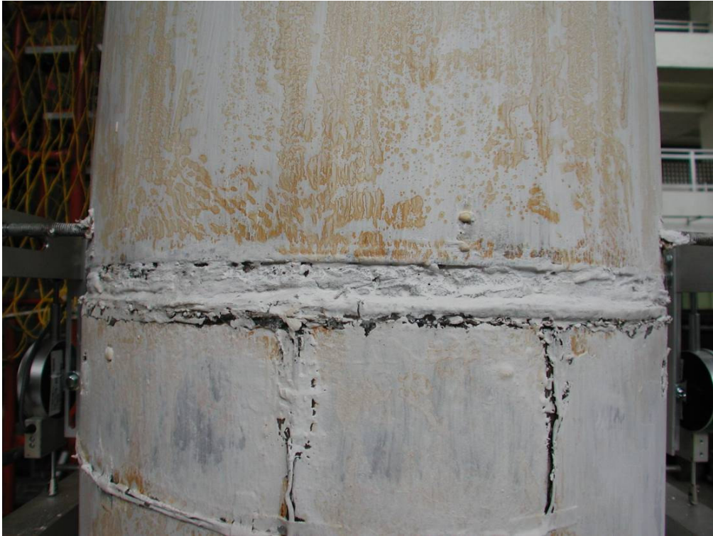
照片 3.81 試體 3 第二、三節塊間混凝土裂縫長度( \theta = +0.03 弧度)
