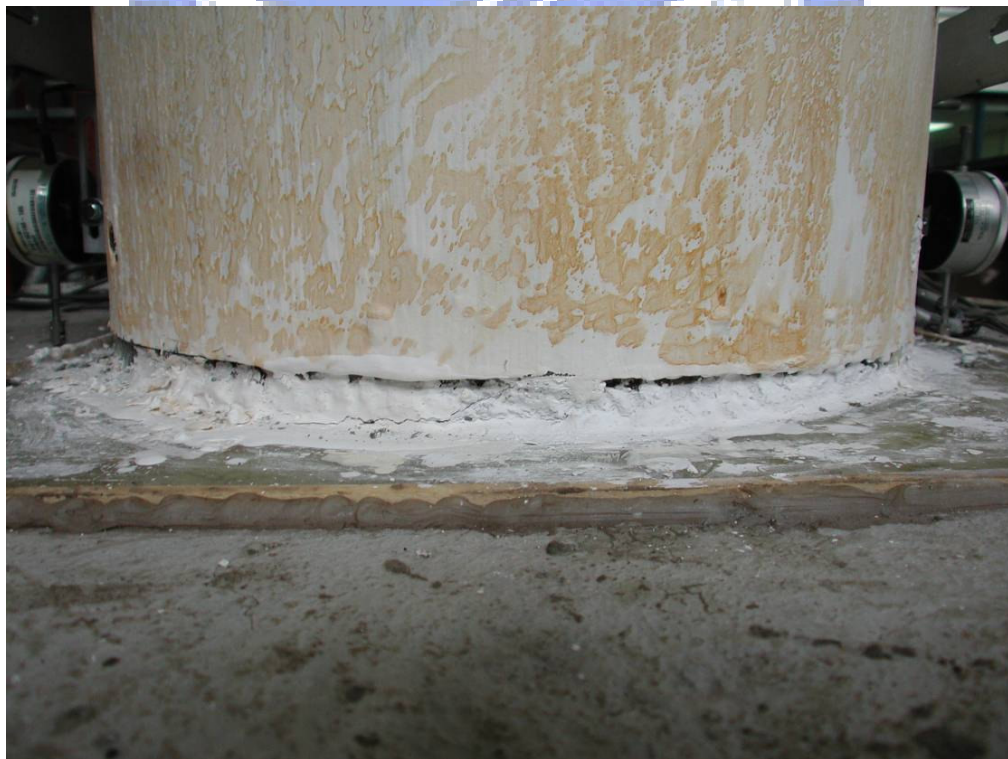
照片 3.72 試體 3 第一節塊柱底混凝土裂縫長度( \theta = +0.02 弧度)
