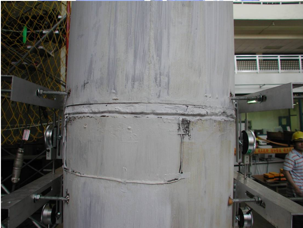
照片 3.52 試體 2 第二、三節塊間混凝土裂縫長度( \theta = +0.05 弧度)
