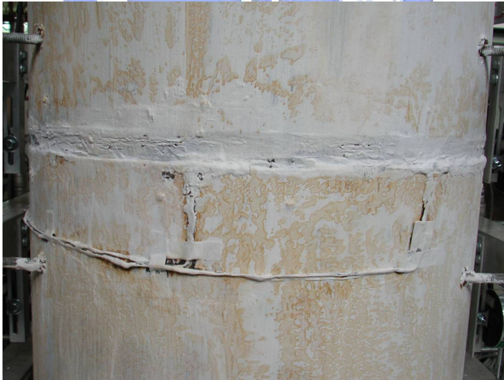
照片 3.70 試體 3 第一、二節塊間混凝土裂縫長度( \theta = +0.015 弧度)
