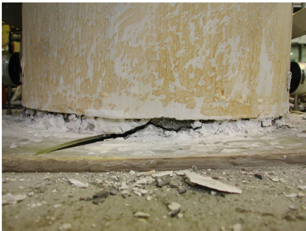
照片 3.95 試體 3 第一節塊柱底混凝土裂縫長度( \theta = +0.06 弧度)
