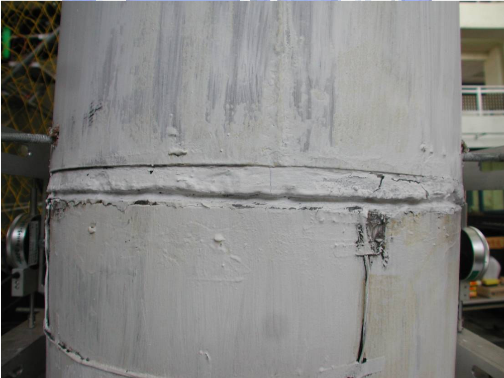
照片 3.58 試體 2 第二、三節塊間混凝土裂縫長度( \theta = +0.06 弧度)
