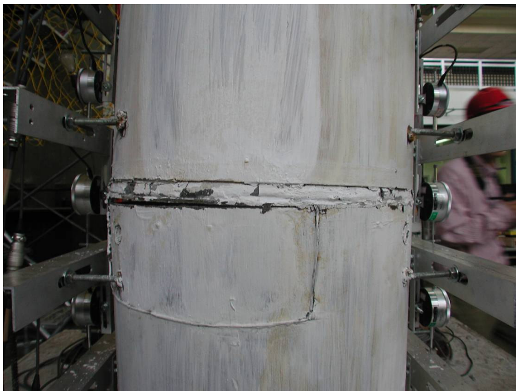
照片 3.49 試體 2 第一、二節塊間混凝土裂縫長度( \theta = +0.05 弧度)
