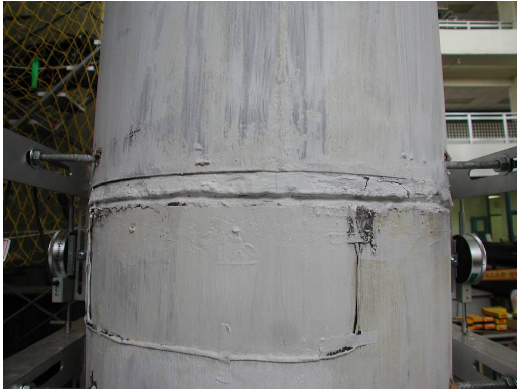
照片 3.47 試體 2 第二、三節塊間混凝土裂縫長度( \theta = +0.04 弧度)
