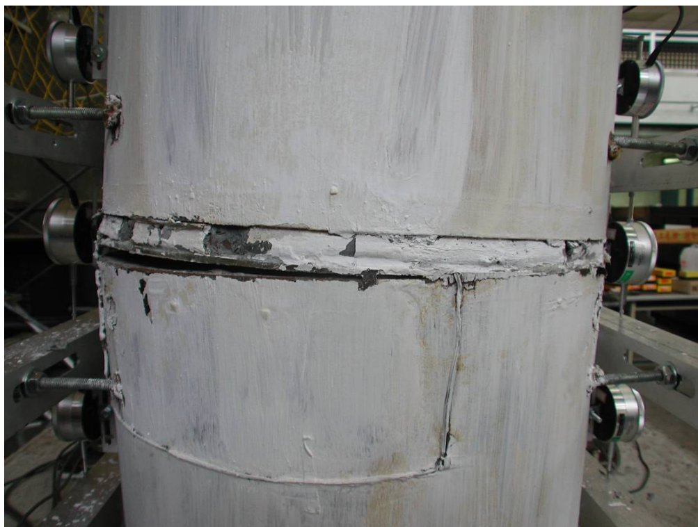
照片 3.55 試體 2 第一、二節塊間混凝土裂縫長度( \theta = +0.06 弧度)
