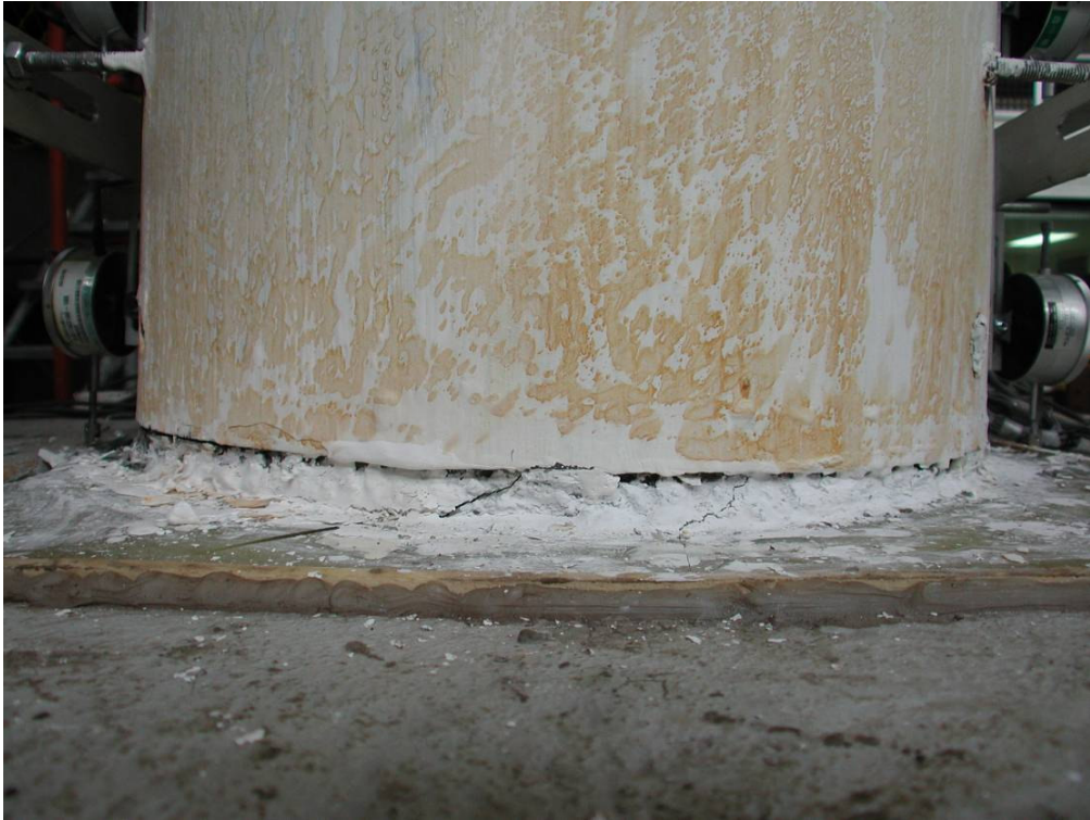
照片 3.83 試體 3 第一節塊柱底混凝土裂縫長度( \theta = +0.04 弧度)
