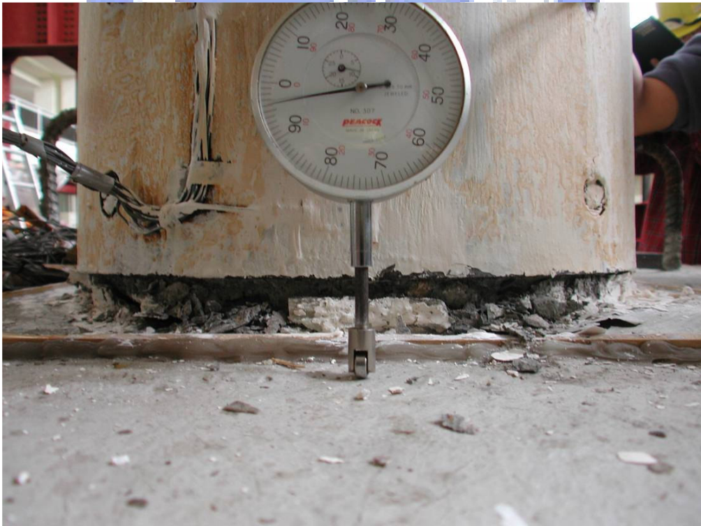
照片 3.82 試體 3 第一節塊柱底撓曲裂縫( \theta = +0.04 弧度)
