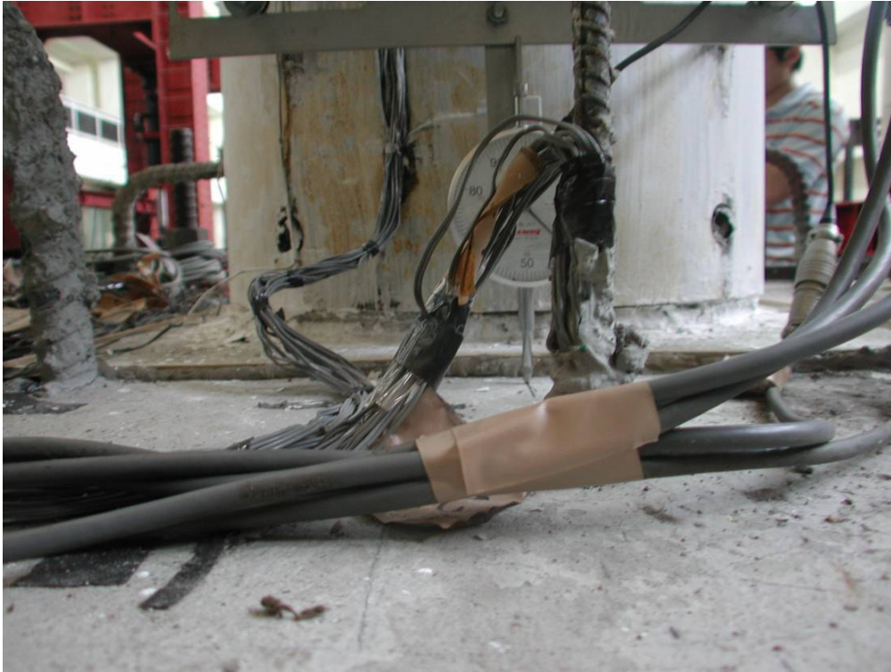
照片 3.43 試體 2 柱底受拉側混凝土開裂情形( \theta = +0.04 弧度)
