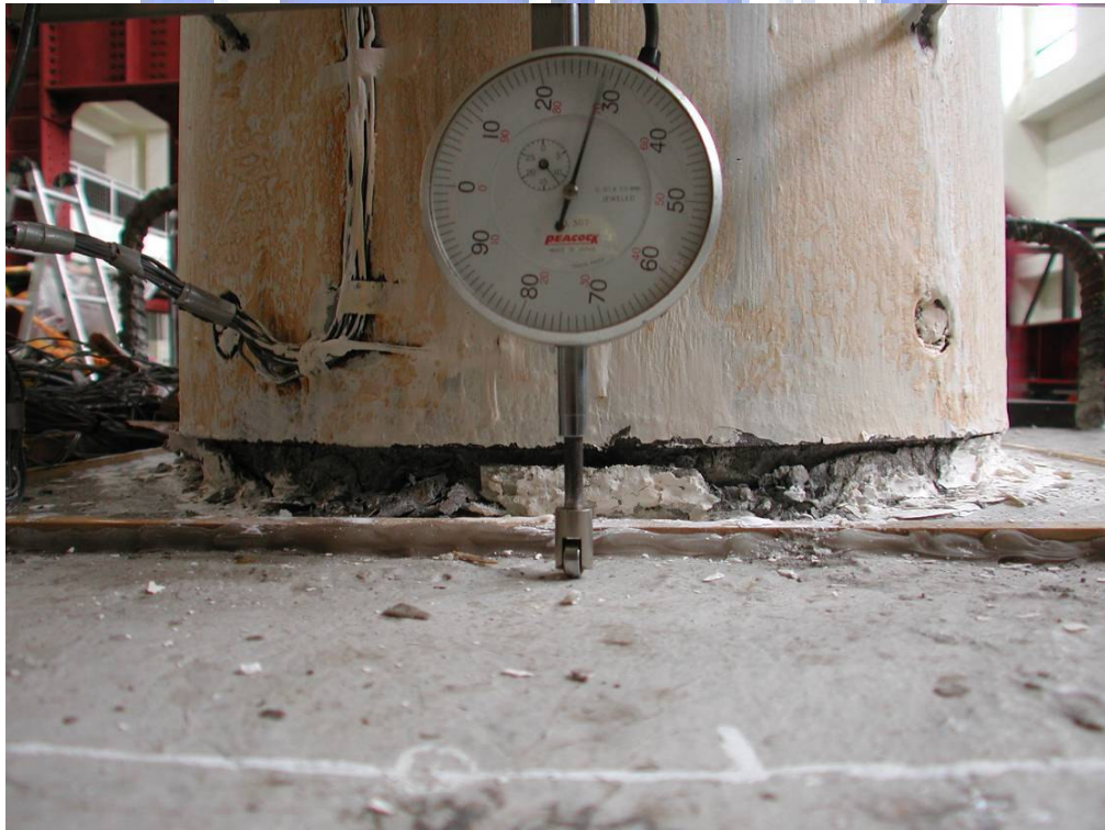
照片 3.76 試體 3 第一節塊柱底撓曲裂縫( \theta = +0.03 弧度)
