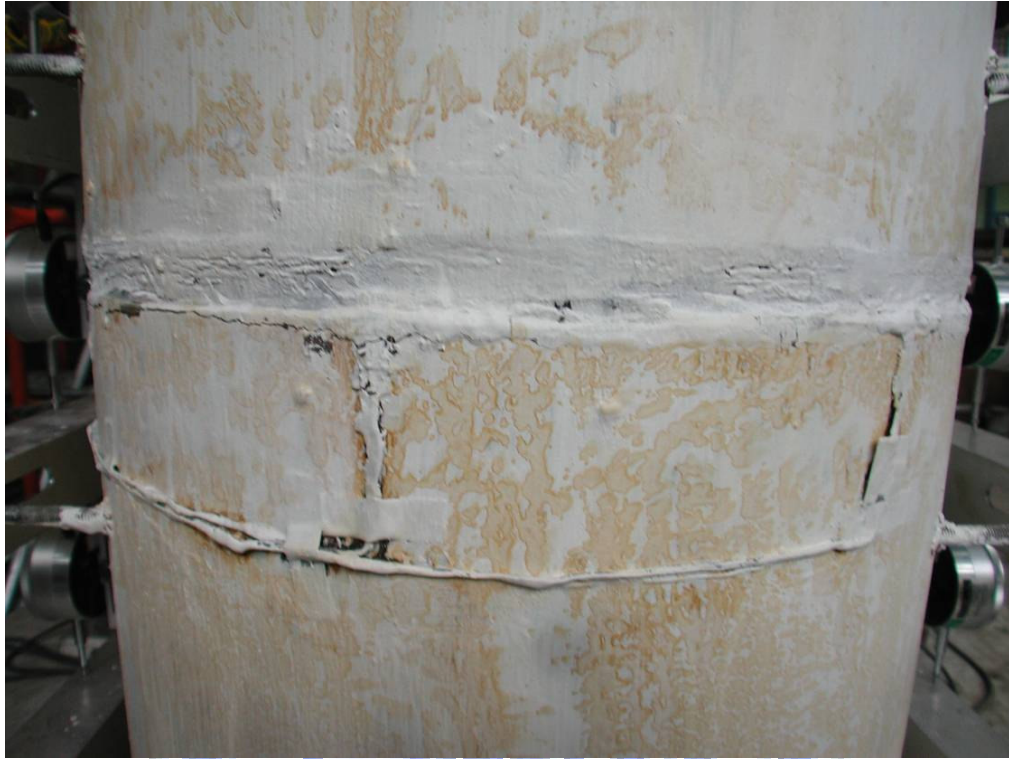
照片 3.79 試體 3 第一、二節塊間混凝土裂縫長度( \theta = +0.03 弧度)
