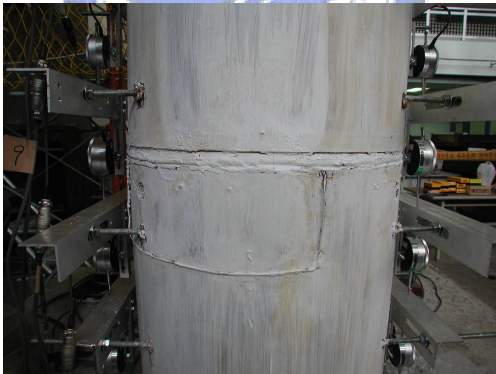
照片 3.32 試體 2 第一、二節塊間混凝土裂縫長度( \theta = +0.015 弧度)
