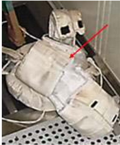
圖 5-8 管路保溫材照片
