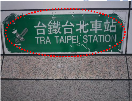
照片 23 標示板面已被磨損(98.12.21)
