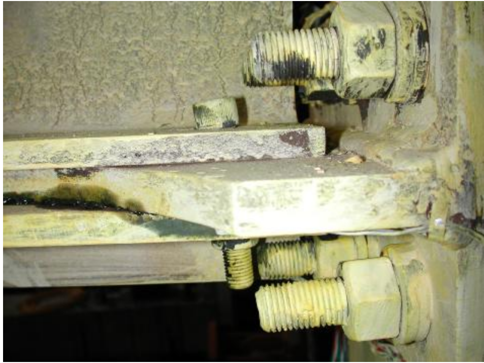
照片 3.47 試體 4 連接 T 型加勁板之前排螺栓傾斜 ( \theta = 0.05 弧度)
