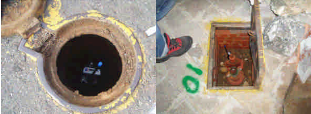
圖 3.9 Permalog 安裝於水管管件上 (雷迪國際實業有限公司, 2006)
