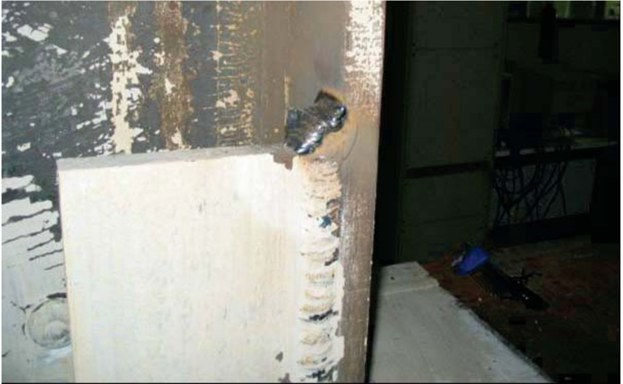
照片 3.55 試體 IFS4 第二次試驗前加勁板與梁接合之裂縫修補
