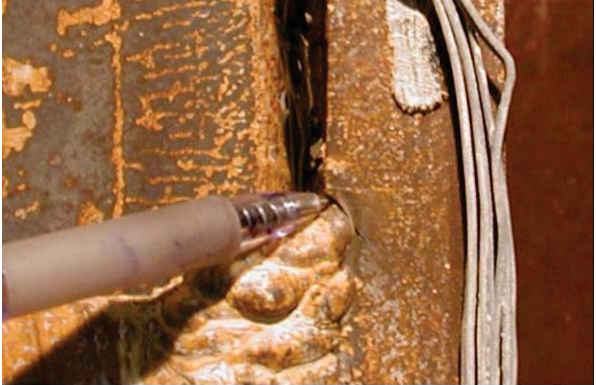
照片 3.79 試體 IFS5 下翼加勁板上方母材裂痕（位移角 \theta = +3.6\% 弧度）
