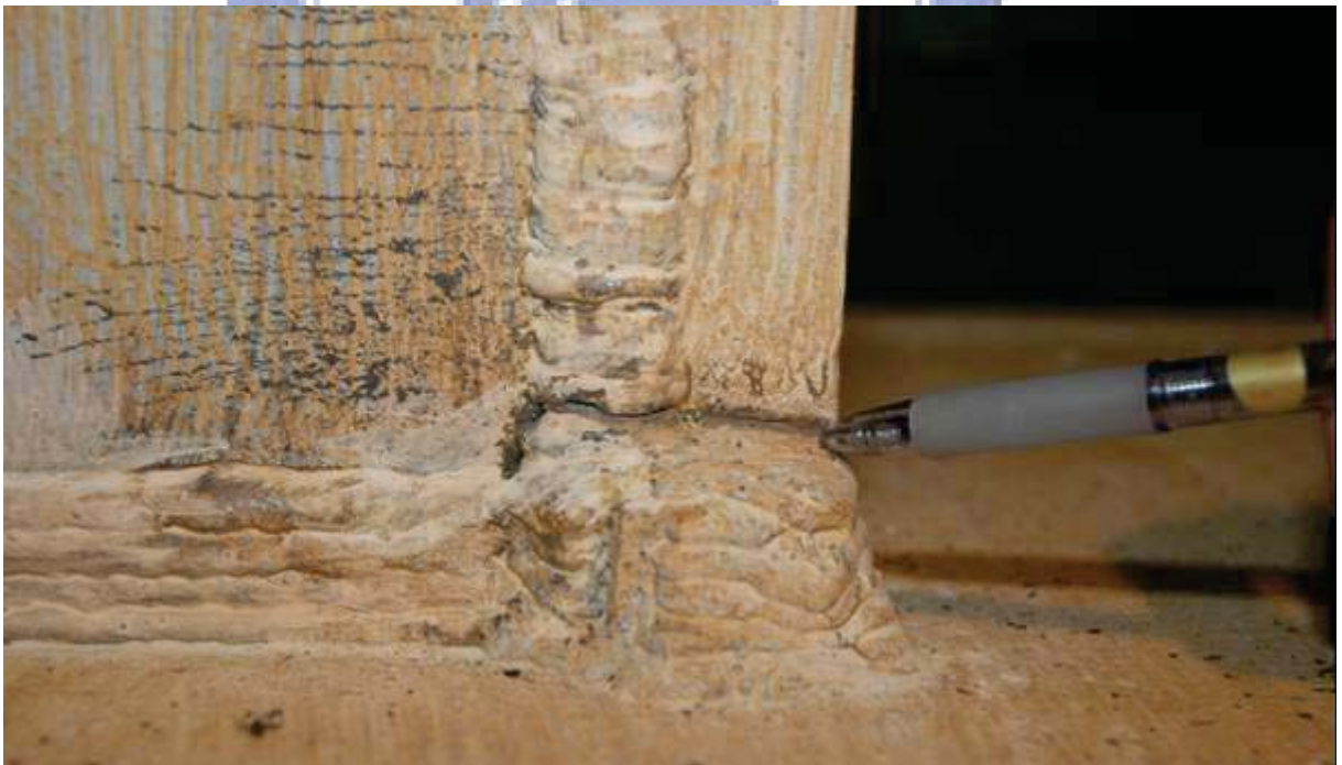
照片 4.56 試體 FDWS3 上翼梁柱接頭焊道上方母材裂痕 ( \theta = -3.0\% 弧度)
