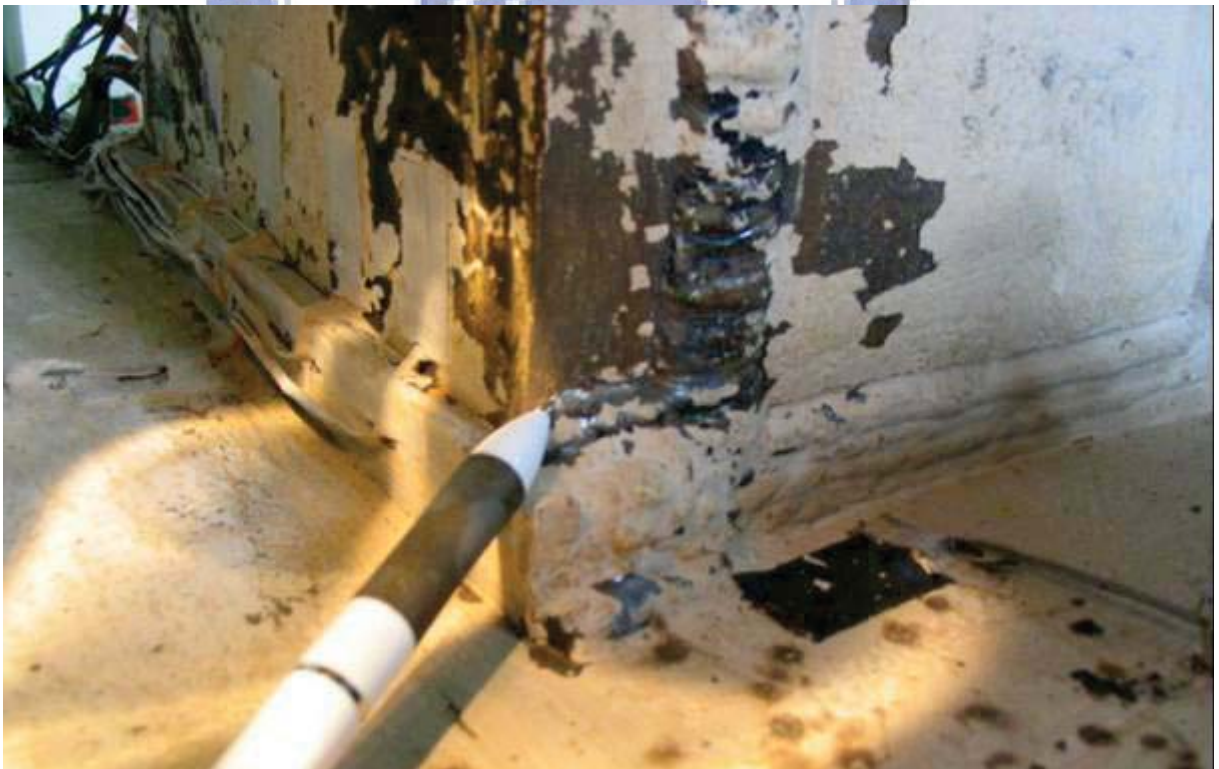
照片 3.58 試體 IFS4 下翼板焊道上方母材出現裂痕 ( \theta=3.0\% 弧度結束)
