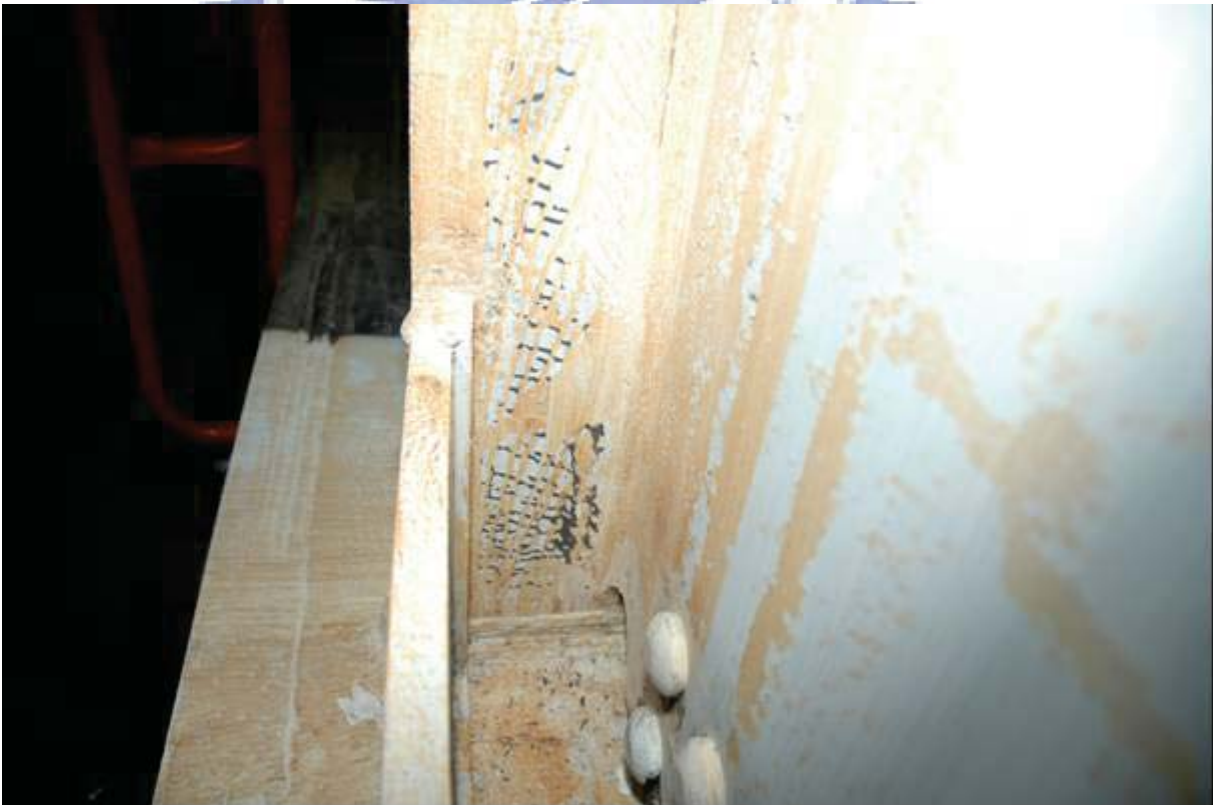
照片 4.38 試體 FDWS3 梁下翼板內側之降伏情形 ( \theta=1.0\% 弧度結束)
