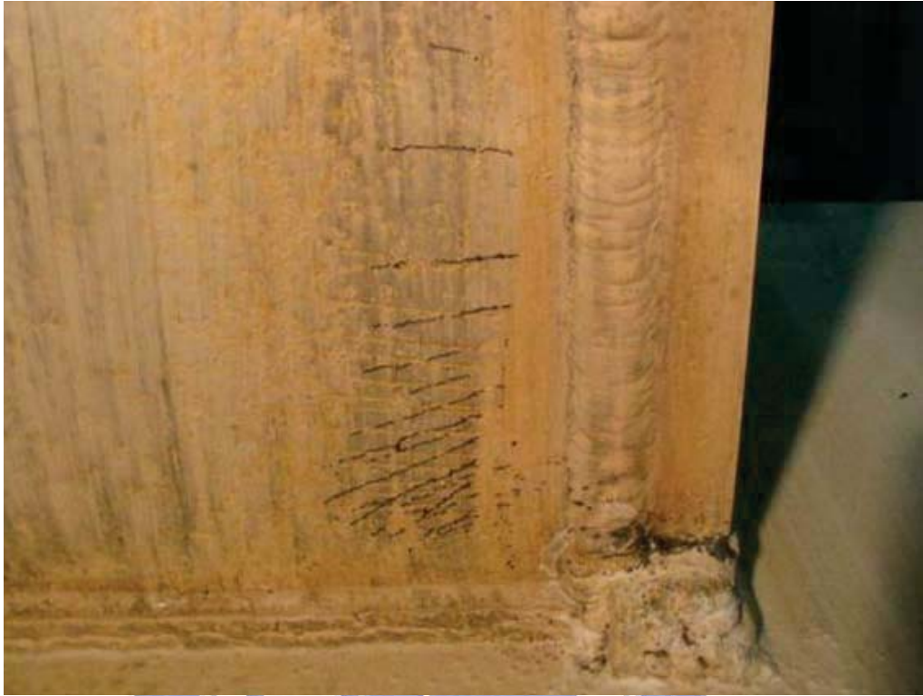
照片 4.25 試體 FDWS2 上翼梁柱接頭焊道上方母材裂痕及加勁板降伏情形
