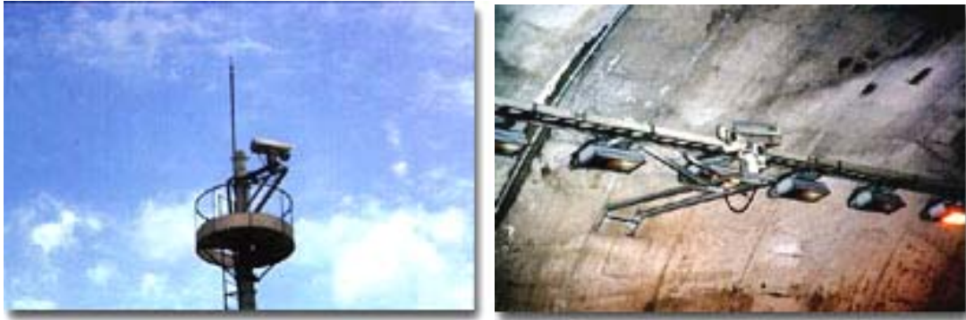
(a) 架設於國道路側之監視器 (b) 架設於國道隧道內之監視器
