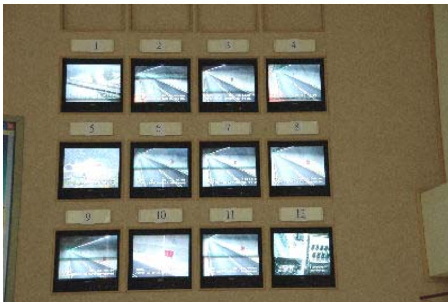
圖 7.2-1 北宜高交控中心多路段同時監控路況之電視牆畫面
