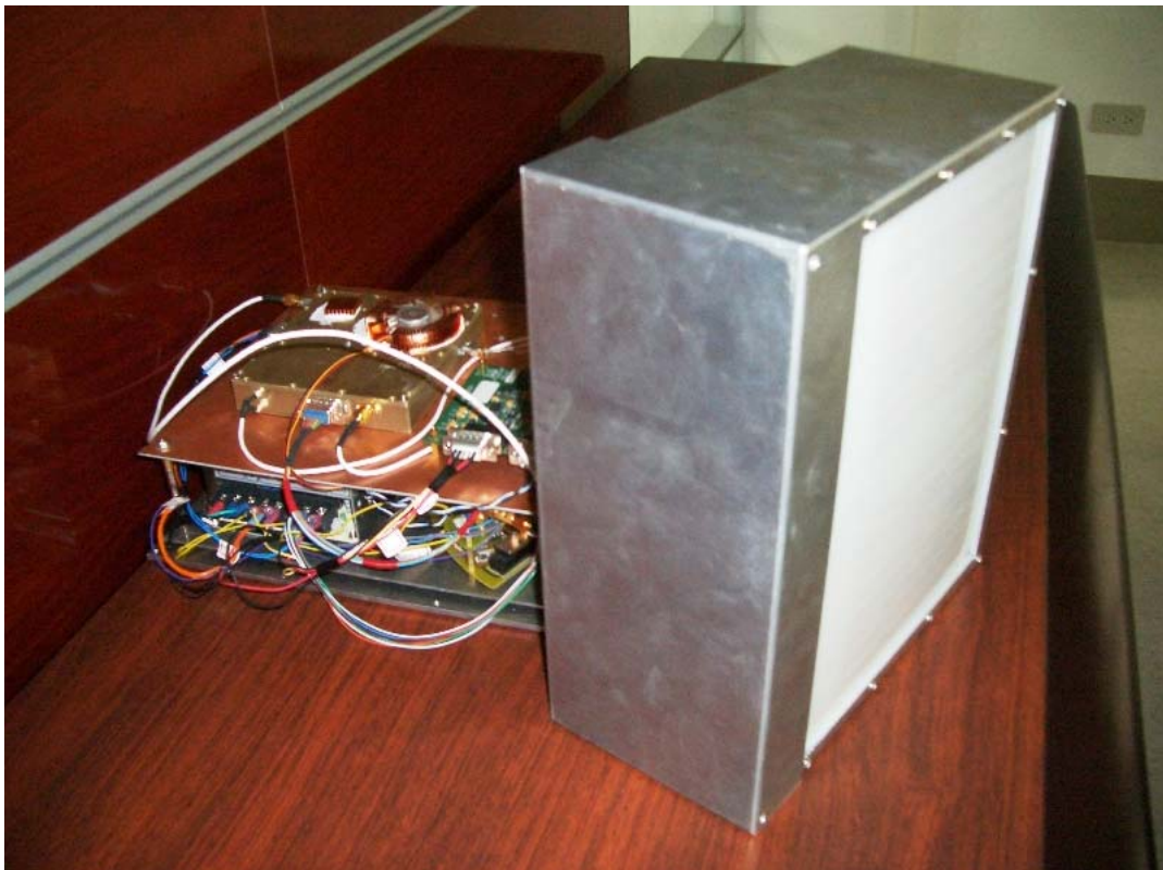
圖 5.3-23 洩漏波天線及電源供應器之輸出
